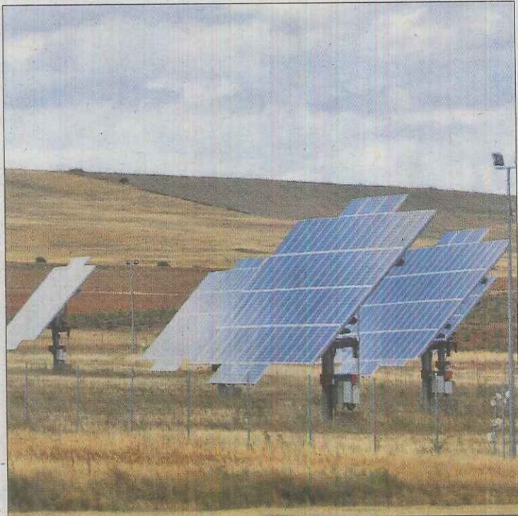
Placas fotovoltaicas en la provincia. MARIO TEJEDOR
