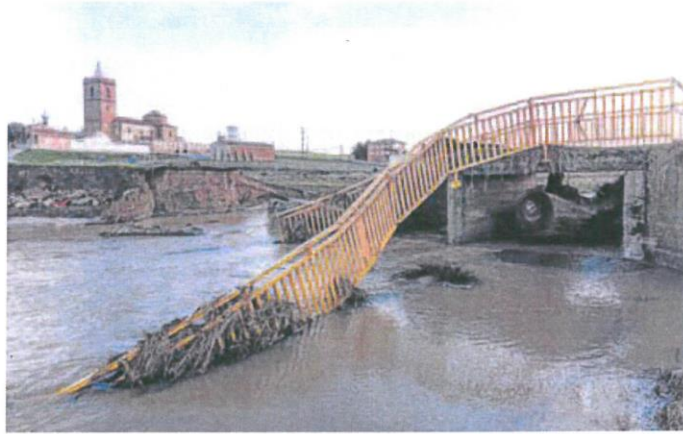
Puente de acceso a la localidad abulense de Cisla destruido por la crecida del río Zapardiel. R. SANCHIDRIÁN-EFE
