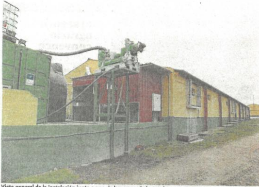
Vista general de la instalación junto a una de las naves de la granja.
